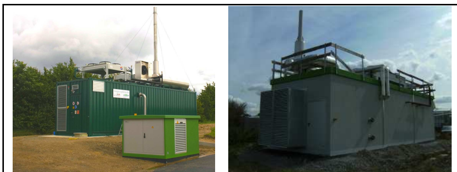
Bild 7: BHKW im Metall- (links) und im Betoncontainer (rechts)
