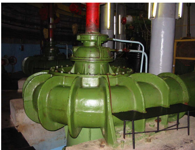
Bild 2: Zentrales Großpumpwerk der Stadt Charkov (Ukraine)
